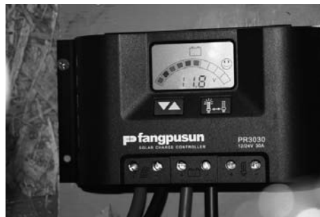
図 3. チャージコントローラーの設置状況
