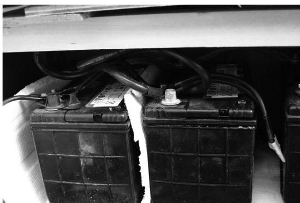
図 2. バッテリーの設置状況
