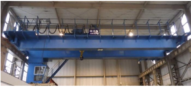
図 3.天井クレーン
