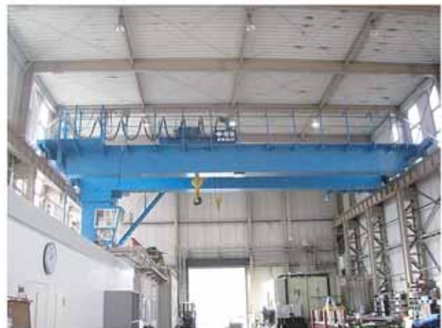
図 6. 大型天井クレーン
