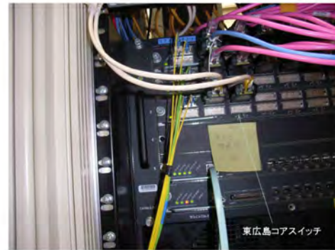
テクノプラザのラック写真2(メイプルネット側機器類)
