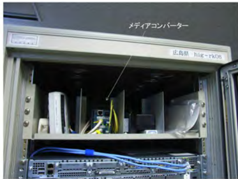
テクノプラザのラック写真1(東広島ケーブルメディア側機器類)
