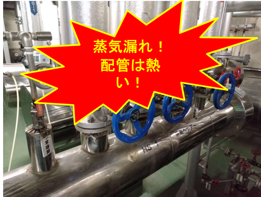
蒸気ヘッダーのバルブ操作
