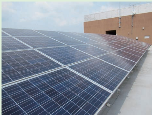
【創エネ】屋上の太陽光パネル (写真はイメージ)
