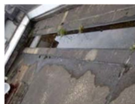
雨水配管の詰まり (屋上排水不良)
