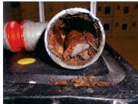
排水管腐食による排水不能
