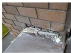
シールの劣化 (タイルの破損)
