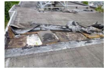
防水層めくれ
