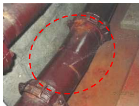
漏水した屋外給水管 (ピンホール)
