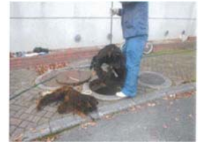
排水管に詰まった木の根
