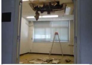
老朽化した排水管の漏水により、天井材が落下
