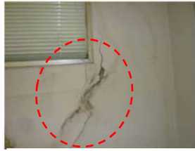
外壁の亀裂から雨水侵入
