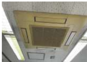
経年劣化で停止した空調機
