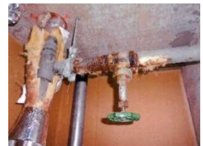
給水管腐食による水漏れ
