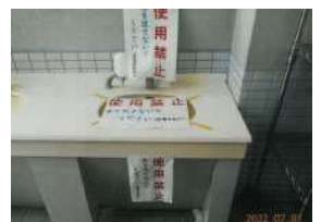
排水不良で使用禁止中の手洗器
