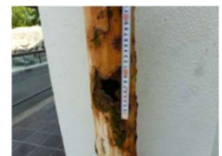
たて樋の腐食
