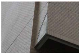
外壁タイル剥落
