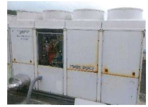
空調室外機の不良、空調停止
