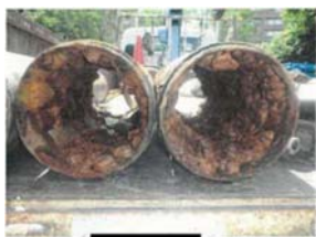
屋外給水管内側の腐食状況 (赤水発生の要因)
