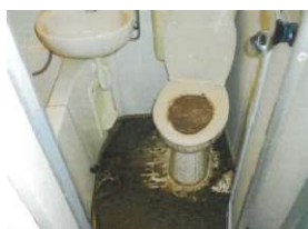
屋外排水管詰まりで逆流した汚物
