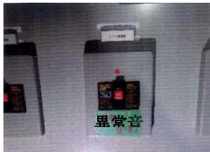
漏電遮断器の不良入
