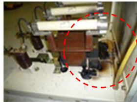
焼損した計器用変圧器 PT
