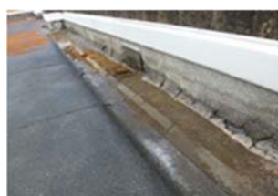
屋上防水の劣化
