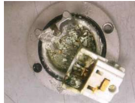
照明端子台腐食による絶縁不良
