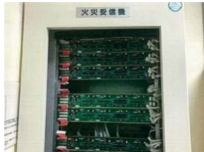
火災受信機の基盤不良
