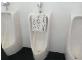
給水不良で使用禁止中の小便器
