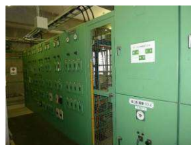
老朽化した受変電設備
