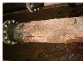
経年劣化により腐食している共同溝内給水管
