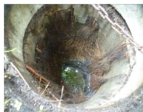
マンホール内に木の根
