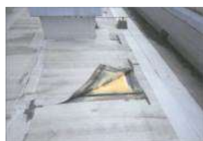
屋上防水シートの劣化
