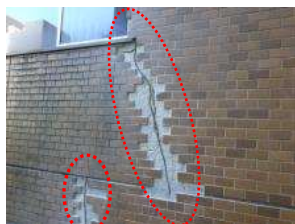
外壁クラック
