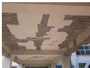
スラブ底の浮き
