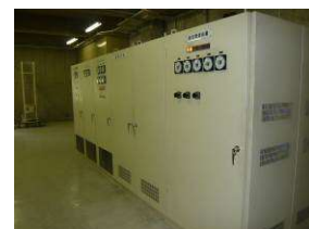
旧式の直流・無停電電源設備
