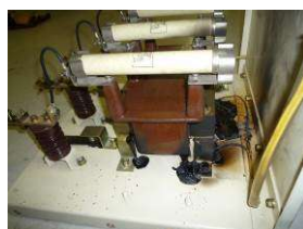
老朽化で焼損した高圧盤内機器
