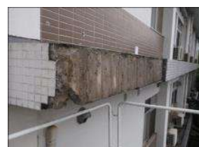
庇タイルの落下
