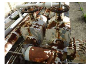
老朽化した給水設備
