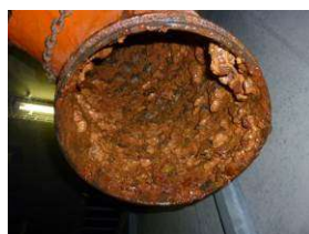
ジョイント溶接部の発錆が激しい給水管
