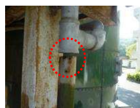
とこの腐食による破断
