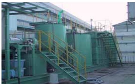
神戸市の下水処理場に建設したパイロットプラント
