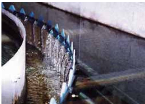
学内排水処理（凝集沈殿槽）
